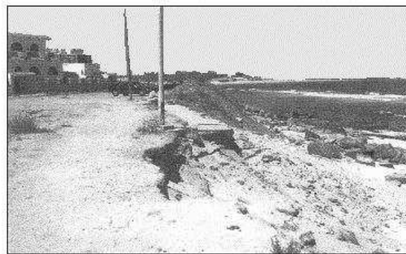
Photo 4 – Vestiges d'une corniche installée sur la haute plage, plage Monika. Remains of a cornice installed in the upper beach, Monika beach.
